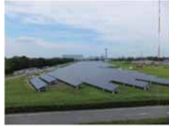
葛蒲久喜ラジオ放送所 太陽光発電システム
