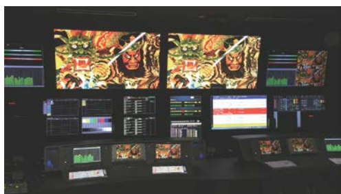
マスターコントロールルーム
