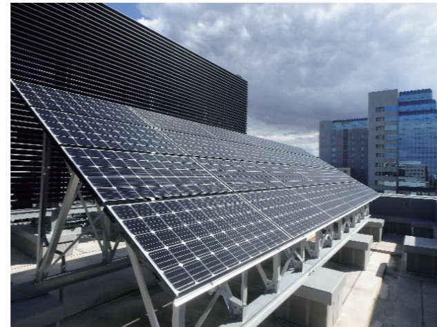
太陽光発電設備
